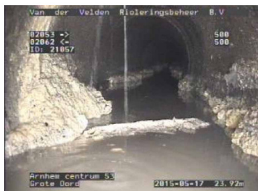
图 1 排水管道中的 FOG 沉积物 [14]
