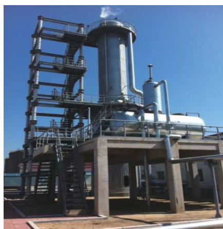
图 3 MVC 处理废水实物图
